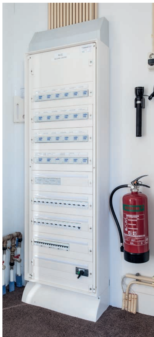
De verdeelkasten herbergen een arsenaal aan schakel- en dimactoren, interfaces en besturingseenheden.
